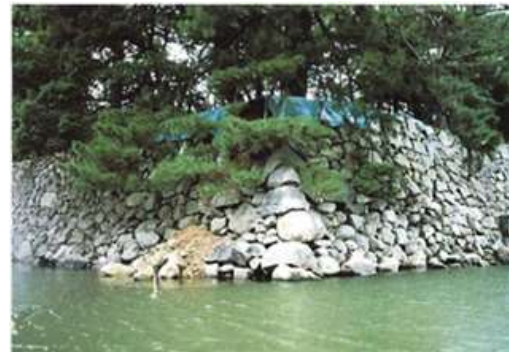
写真-1 二之丸下ノ段南東角堀の石垣崩壊
